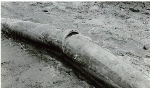
写真 2 破損した鋼管 1)
