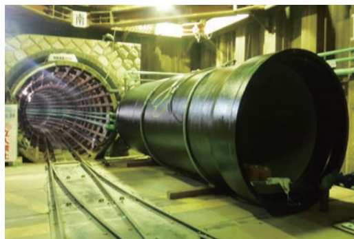
写真2 導水施設の二重化整備状況
