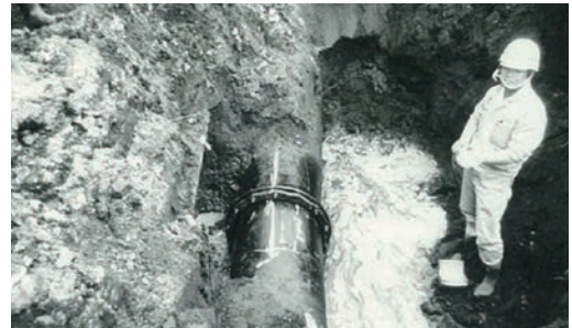
写真 3 継手部からの漏水 1)
