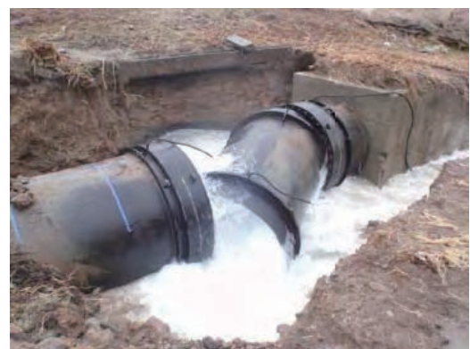
写真1 非耐震継手管(呼び径2400)の抜け出し(東日本大震災)
