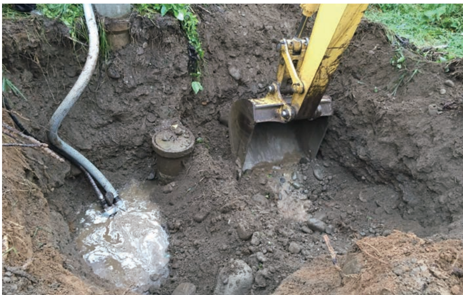
写真1 漏水事故への対応
