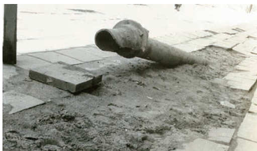
写真1 地上に突出した鑄鉄管の破損 1)
