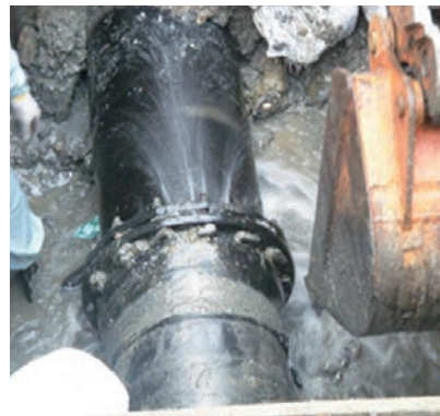
写真 1 漏水した管路 (A 形鉄管 継手漏水)
