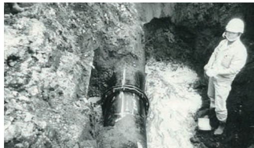
写真3 継手部からの漏水 1)
