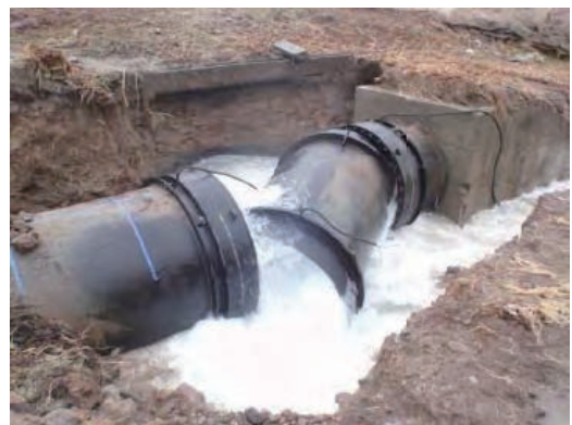
(出典元:厚生労働省・公益社団法人日本水道協会) 写真1 非耐震継手管(呼び径2400)の抜出し(東日本大震災)
