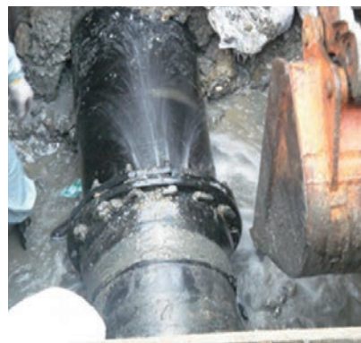
写真 1 漏水した管路 (A 形鉄管 継手漏水)
