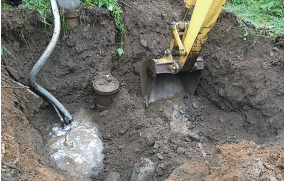
写真1 漏水事故への対応
