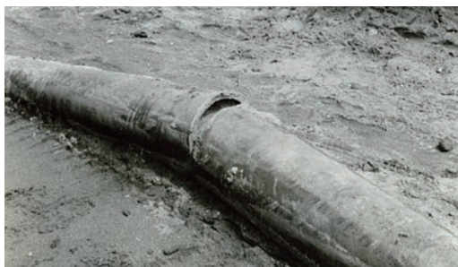
写真2 破損した鋼管 1)
