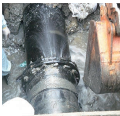
写真 1 漏水した管路（A 形鉄管 継手漏水）
