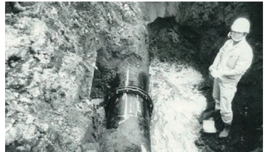
写真 3 継手部からの漏水 1)
