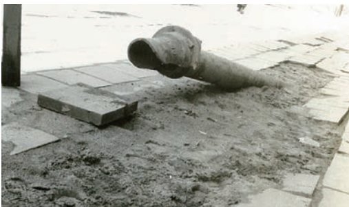
写真 1 地上に突出した铸铁管の破損 1)
