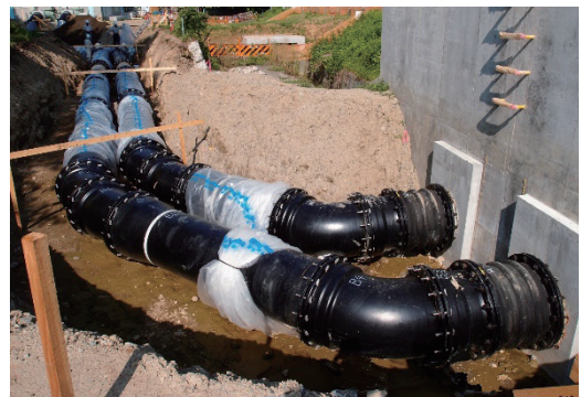
写真2 調圧水槽付近 鎖構造配管状況
