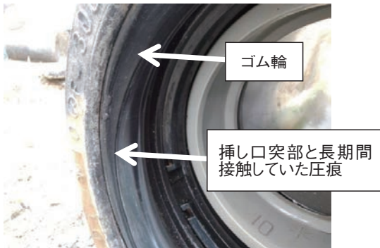
写真8 漏水箇所のゴム輪の圧痕
