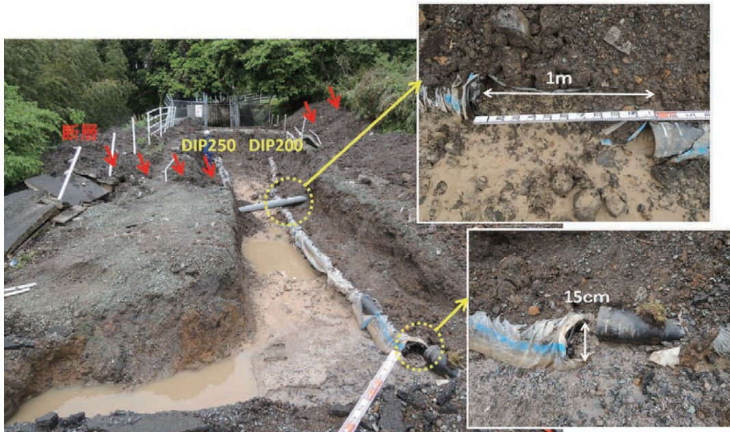
図8 断層横断部の管路被害状況(西原村小森) ＜呼び径200A形ダクタイル鉄管＞
