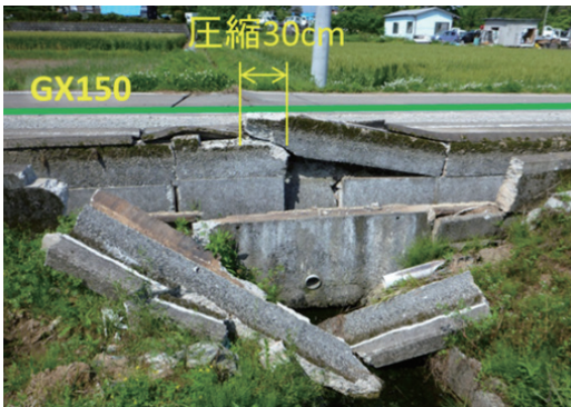
写真5 耐震継手ダクタイル鉄管の布設場所(嘉島町) 〈呼び径150GX形ダクタイル鉄管〉
