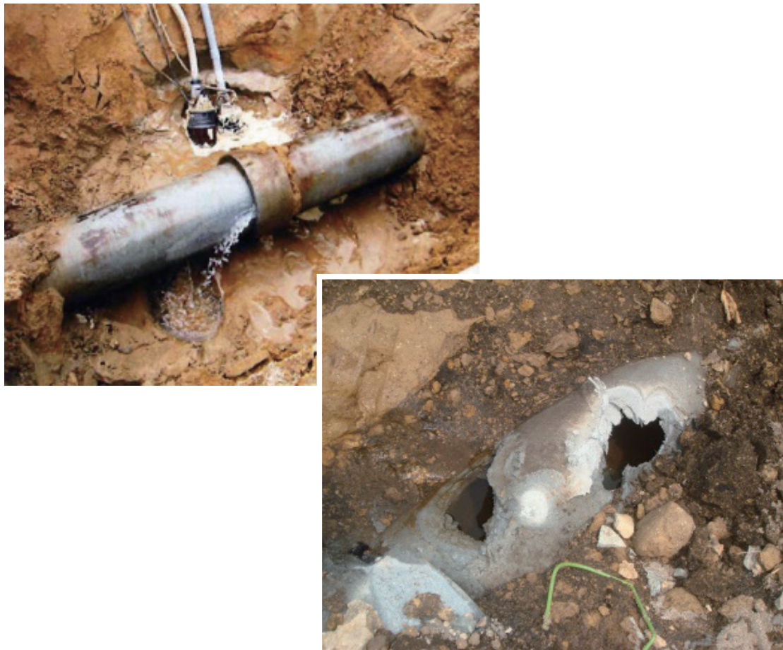
写真1 突発事故の状況
