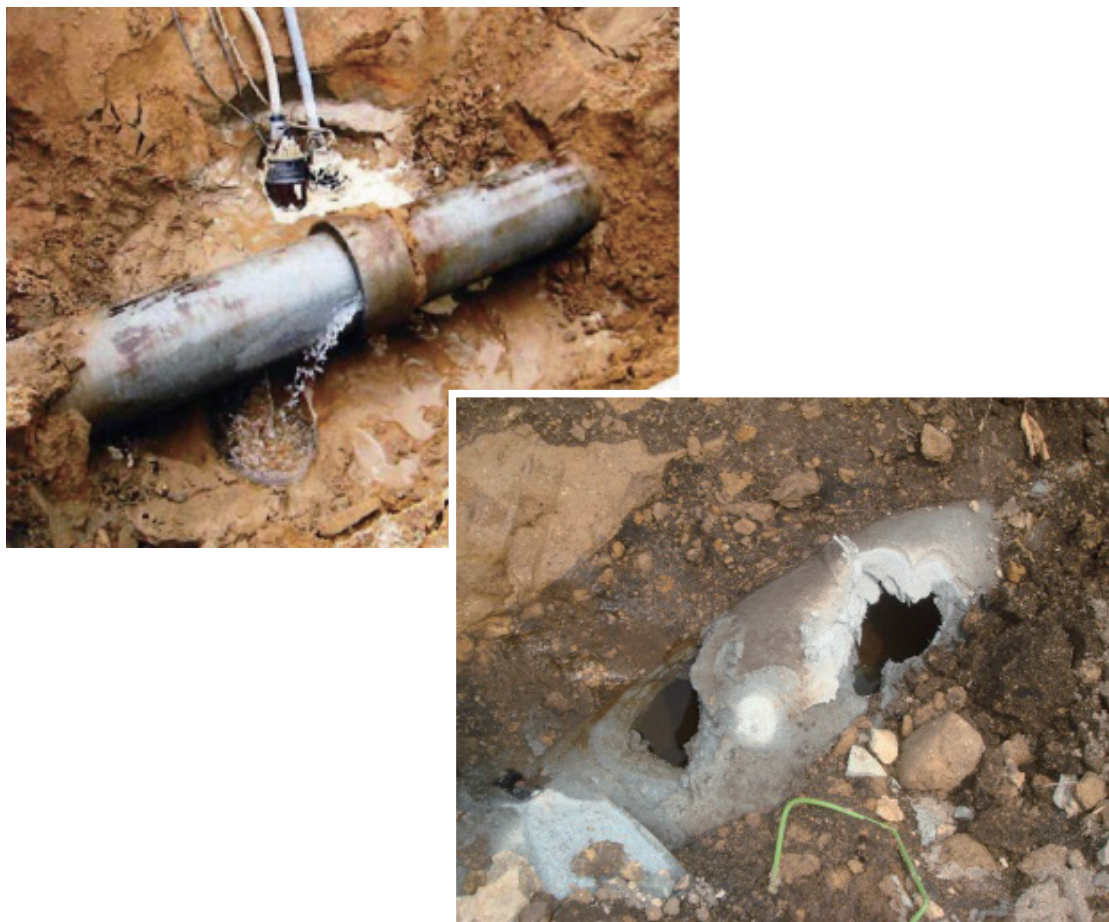
写真1 突発事故の状況
