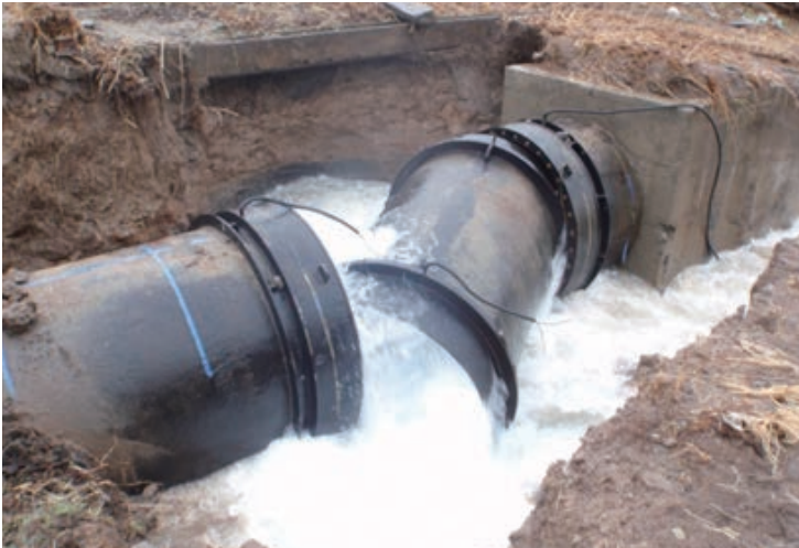
仙南・仙塩広水 伸縮可とう管離脱
