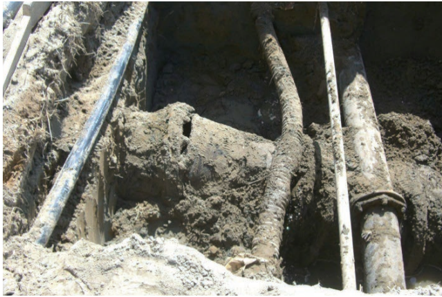
写真1 継手部の離脱状況(鹿嶋市)
