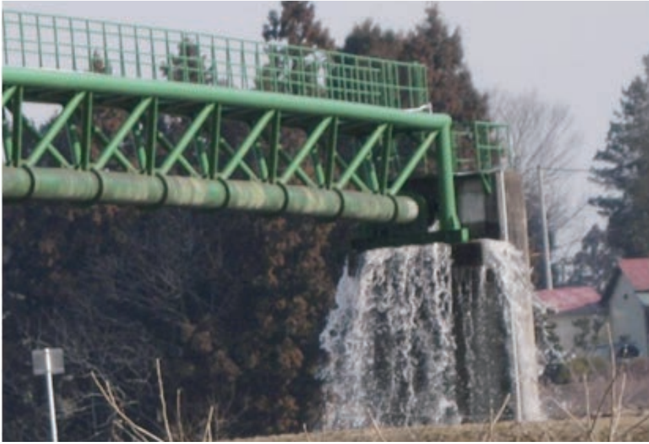
大崎広水 水管橋伸縮管離脱
