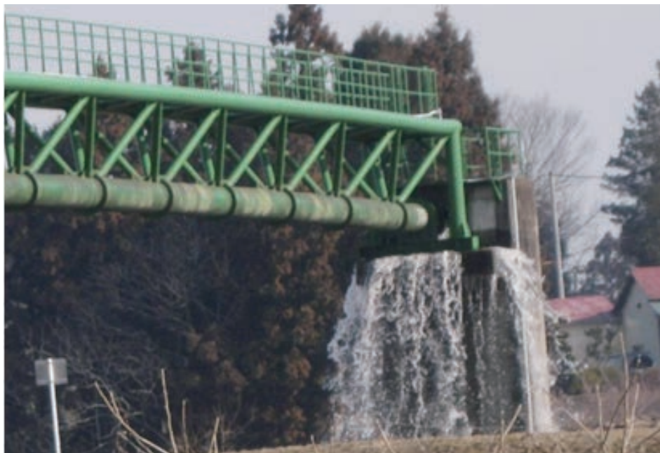
大崎広水 水管橋伸縮管離脱
