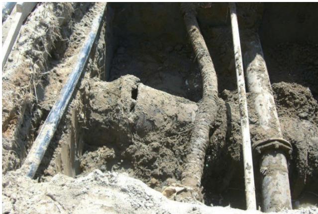
写真1 継手部の離脱状況(鹿嶋市)
