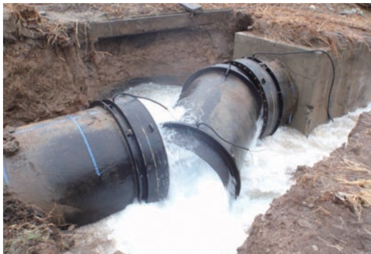
仙南・仙塩広水 伸縮可とう管離脱
