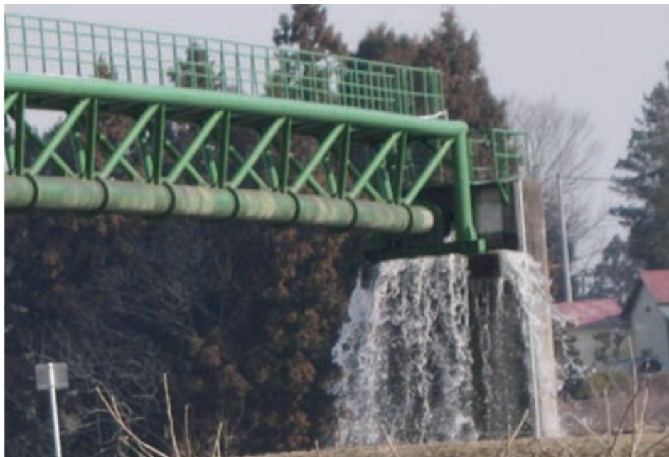
大崎広水 水管橋伸縮管離脱
