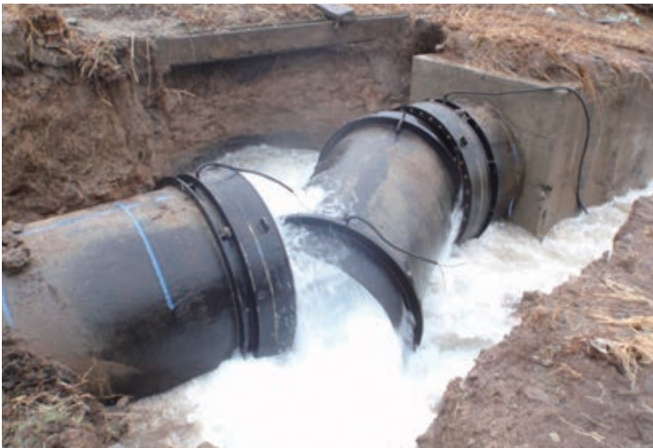
仙南・仙塩広水 伸縮可とう管離脱
