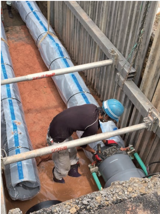
静岡県・牧之原市建設部水道課 GX形 呼び径400・NS形 呼び径 350
