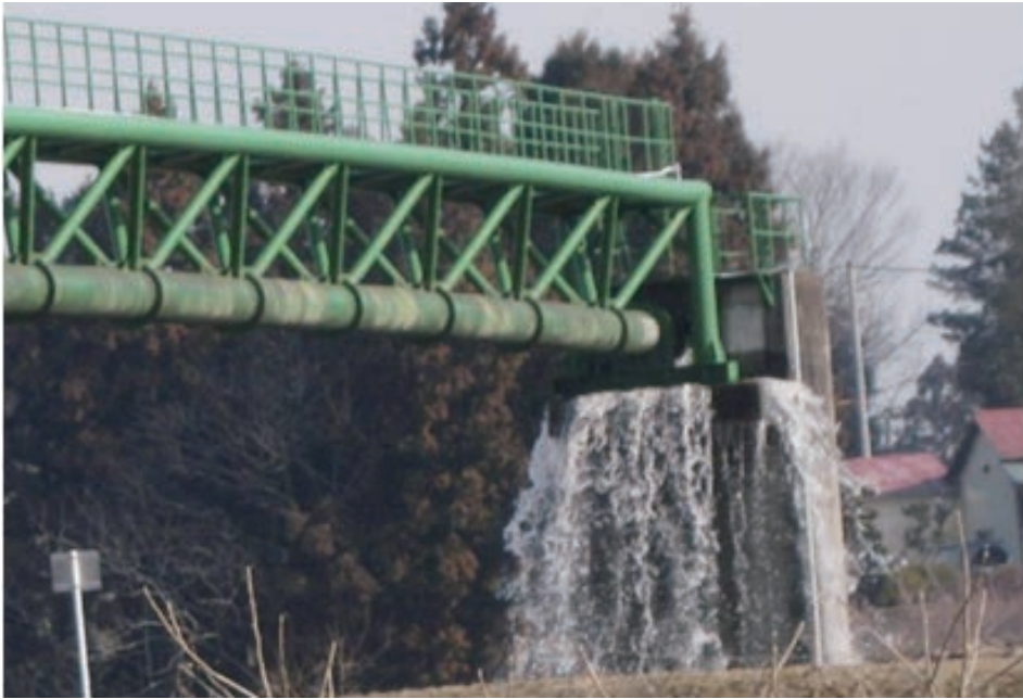
大崎広水 水管橋伸縮管離脱
