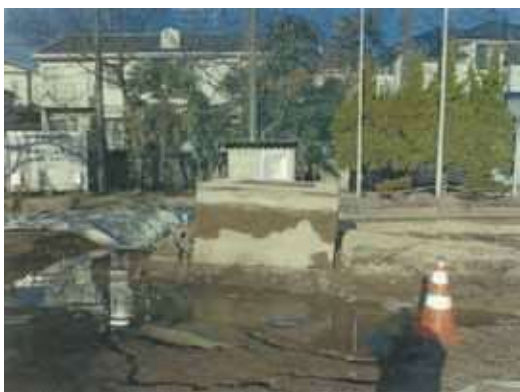
写真2 被災状況(流入・流出部)
