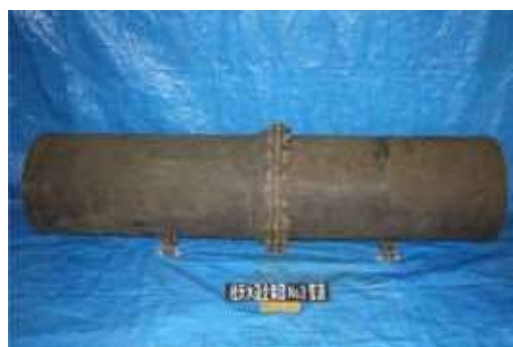
図13 53年間使用された管の外観状況
