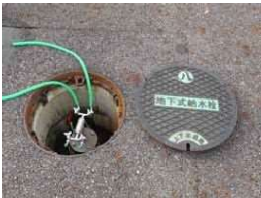
写真2 地下式給水栓
