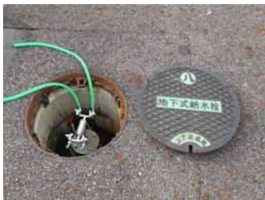
写真2 地下式給水栓
