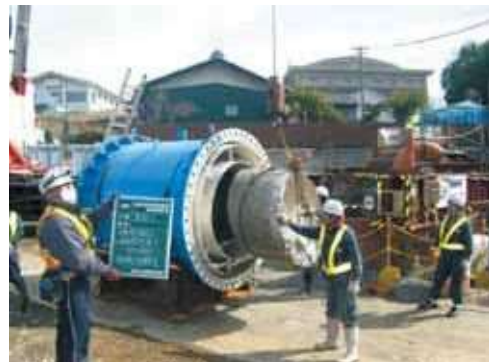
写真4 コンクリート切片引抜状況
