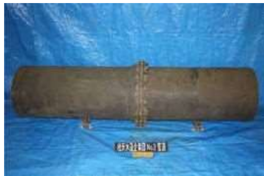
図13 53年間使用された管の外観状況
