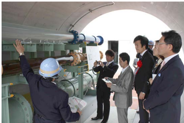
写真3 透明配管による可視化
