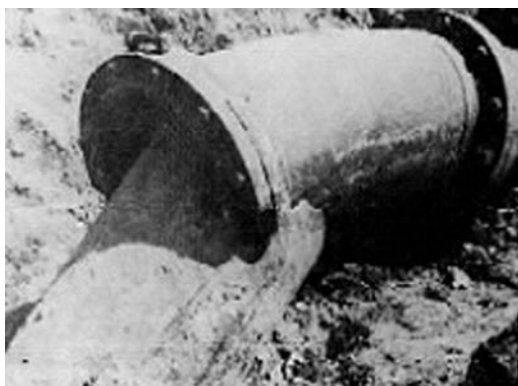
写真1 福井地震における配水管の損壊
