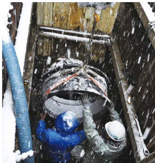
雪の中で続けられる復旧作業 (国見第二配水幹線漏水修繕、口径800mm)
