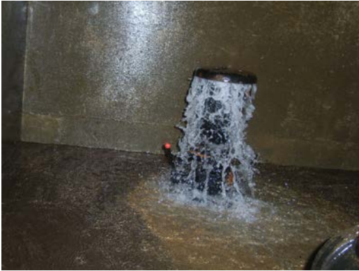
写真2 空気弁漏水状況
