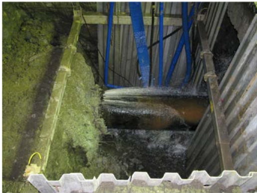
写真3 DIP (K) φ500 漏水状況
