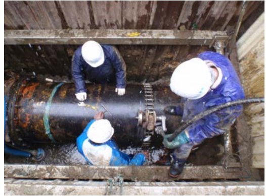
写真4 DIP (K) φ800 継手部漏水 修繕状況
