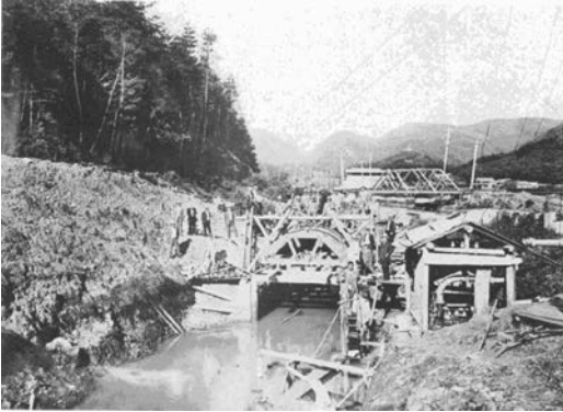
写真1 第二疏水柳山トンネル東口埋立水路工事 (明治42年9月撮影)
