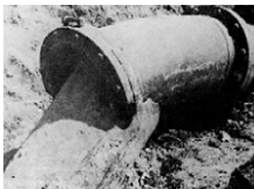
写真1 福井地震における配水管の損壊
