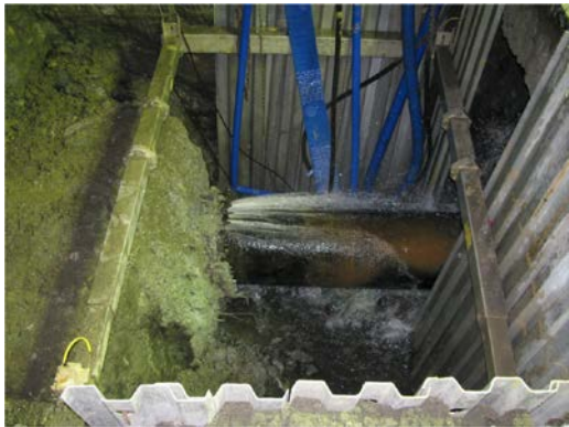
写真3 DIP (K) φ500 漏水状況
