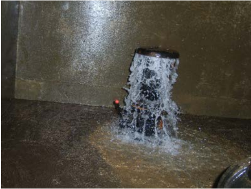
写真2 空気弁漏水状況
