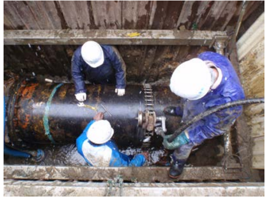
写真4 DIP (K) φ800 継手部漏水 修繕状況
