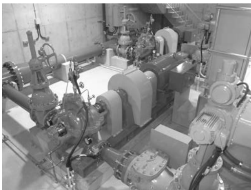
写真7 柿下増圧ポンプ場
