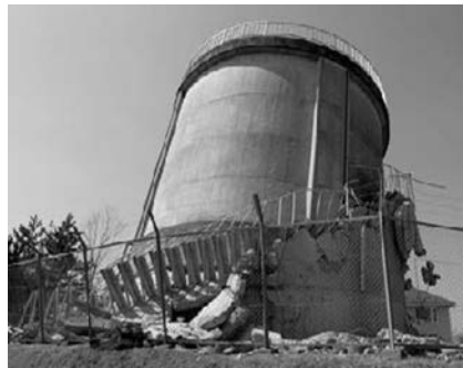
写真1 倒壊した沢配水池
