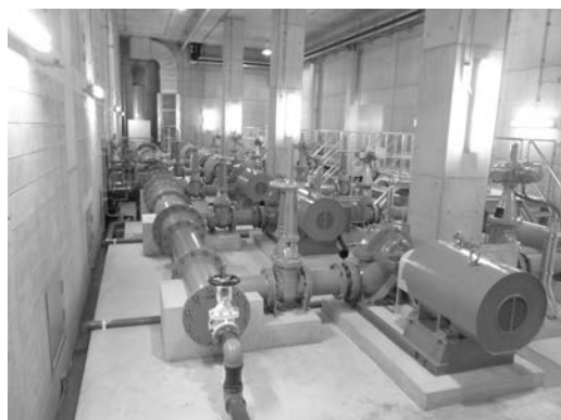
写真6 川合浄水場送水ポンプ
