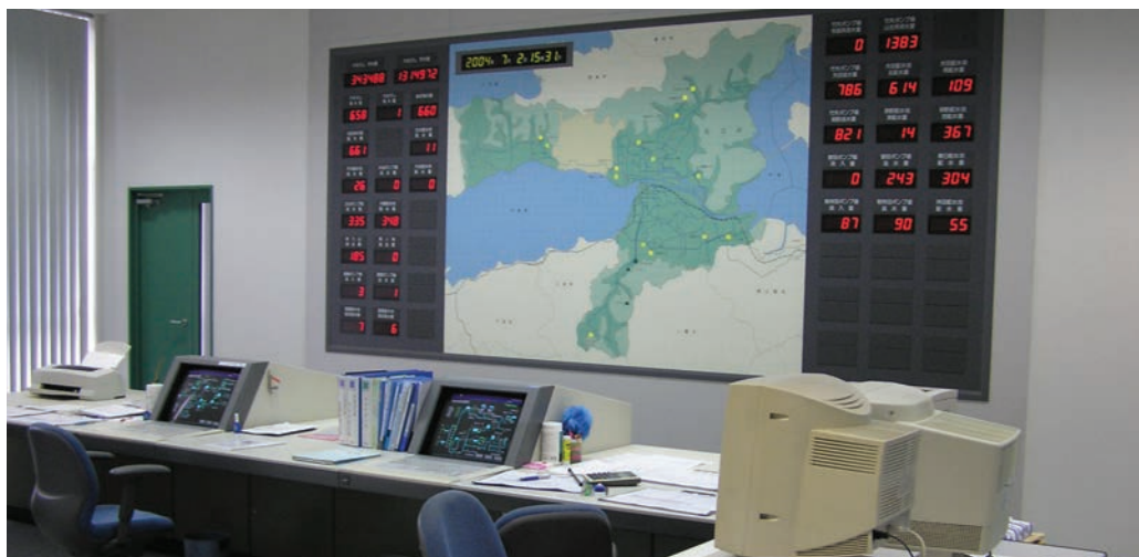
中央監視センター
