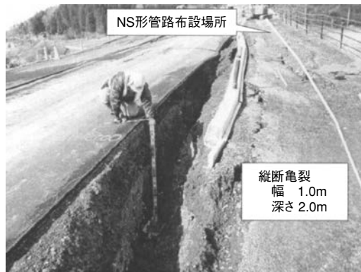
写真8 縦断亀裂 測点1460m付近
