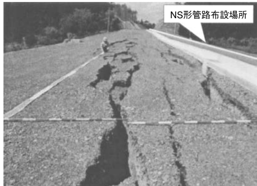
写真6 縦断亀裂 測点1260m付近
