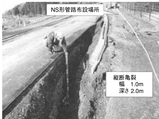
写真8 縦断亀裂 測点1460m付近
