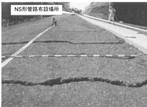
写真5 横断亀裂 測点1230m付近
