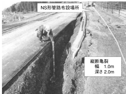
写真8 縦断亀裂 測点1460m付近
