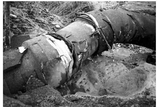
写真2 平成6年度断水事故ペローズ部
