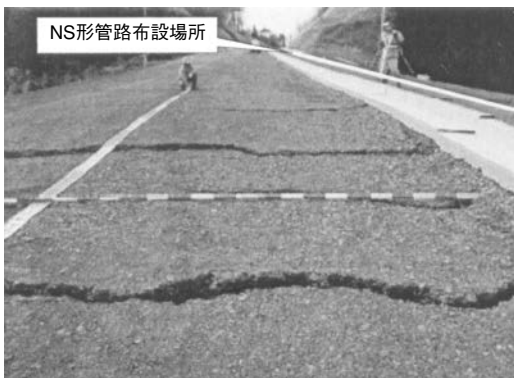
写真5 横断亀裂 測点1230m付近
