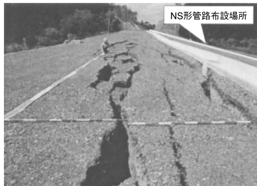
写真6 縦断亀裂 測点1260m付近
