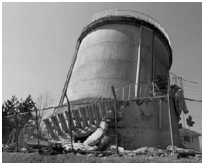
写真1 倒壊した沢配水池
