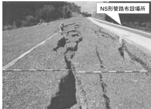
写真6 縦断亀裂 測点1260m付近
