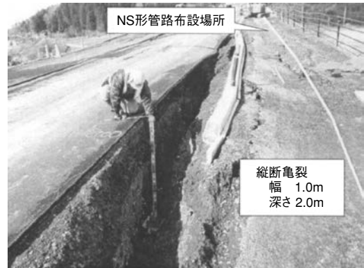
写真8 縦断亀裂 測点1460m付近
