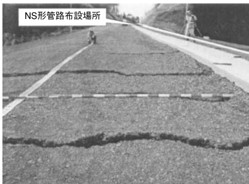
写真5 横断亀裂 測点1230m付近
