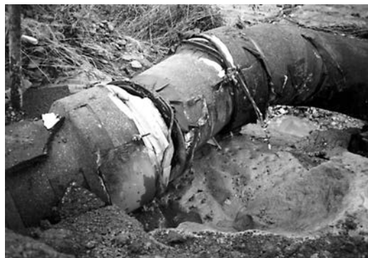
写真2 平成6年度断水事故ペローズ部
