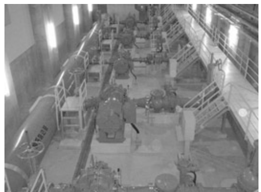
写真1 本城浄水場内送水ポンプ
