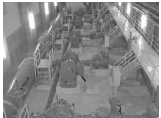
写真1 本城浄水場内送水ポンプ
