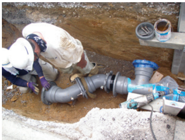
大阪府 河南町 まち創造部上下水道課 呼び径 150
