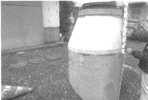
写真1 マンホール浮上
