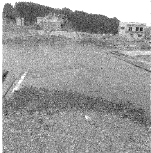
写真5 津波による道路流失
