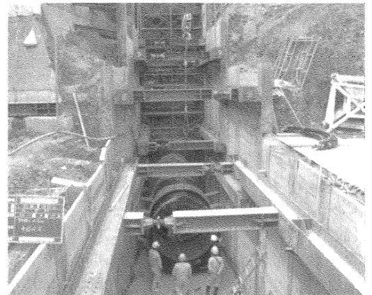
写真6 浄水場導水管呼び径2200US形管
