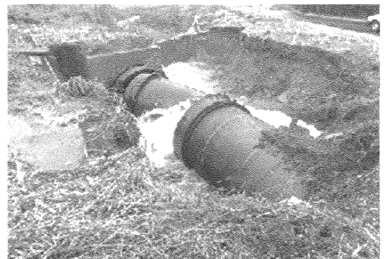
写真9 構造物との取り合い部での呼び径2400鋼製可とう管の抜け 7)
