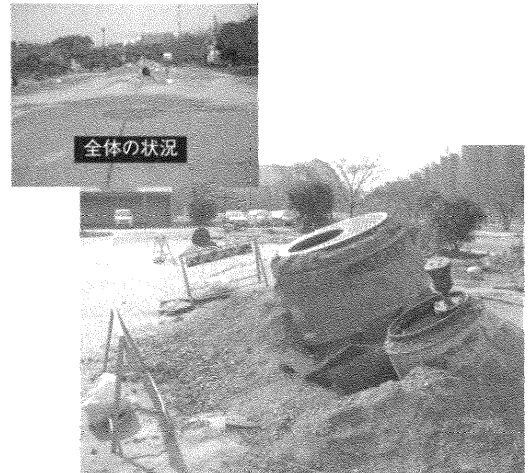
写真7 液状化による貯水槽(鋼製)の浮き上がり
