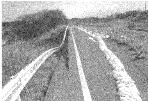
写真3 盛土部の崩壊
