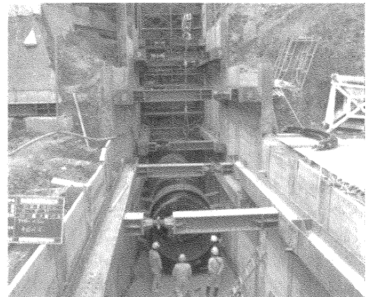
写真6 浄水場導水管呼び径2200US形管
