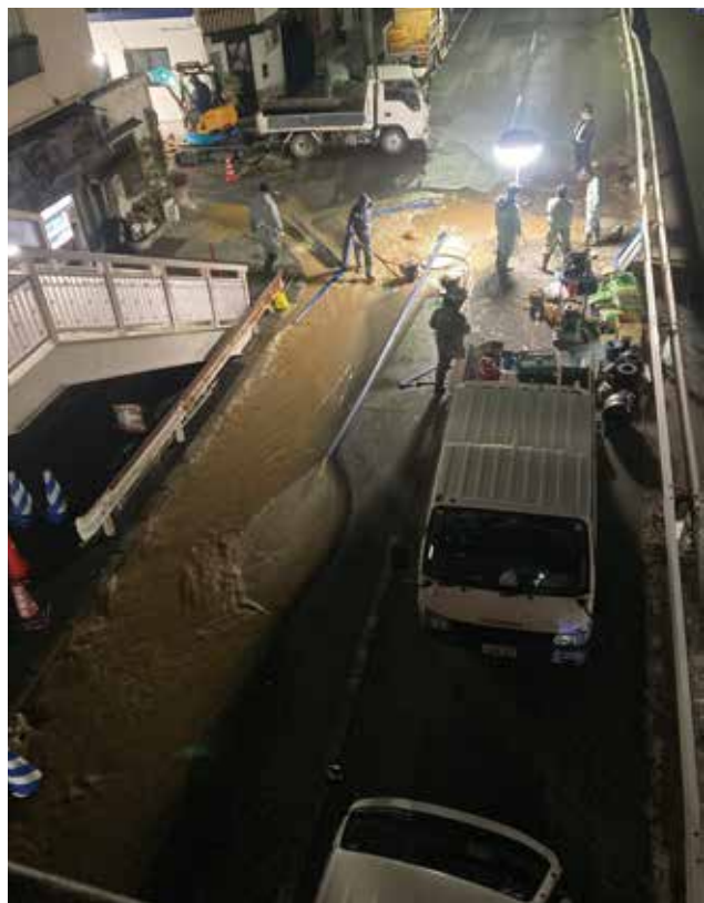
水道管漏水現場状況
