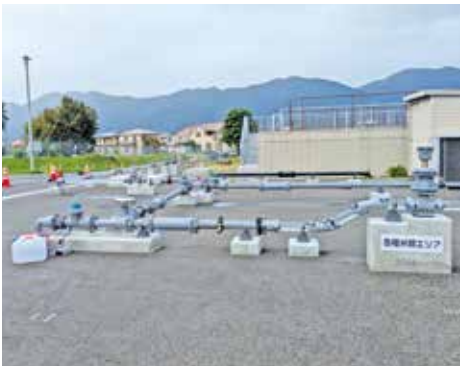
研修設備（地上配管部）
