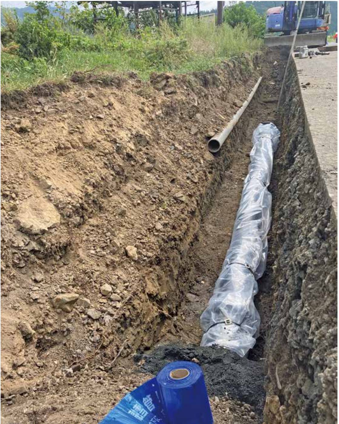
滋賀県長浜土木事務所 木之本支所 K 形 呼び径 200
