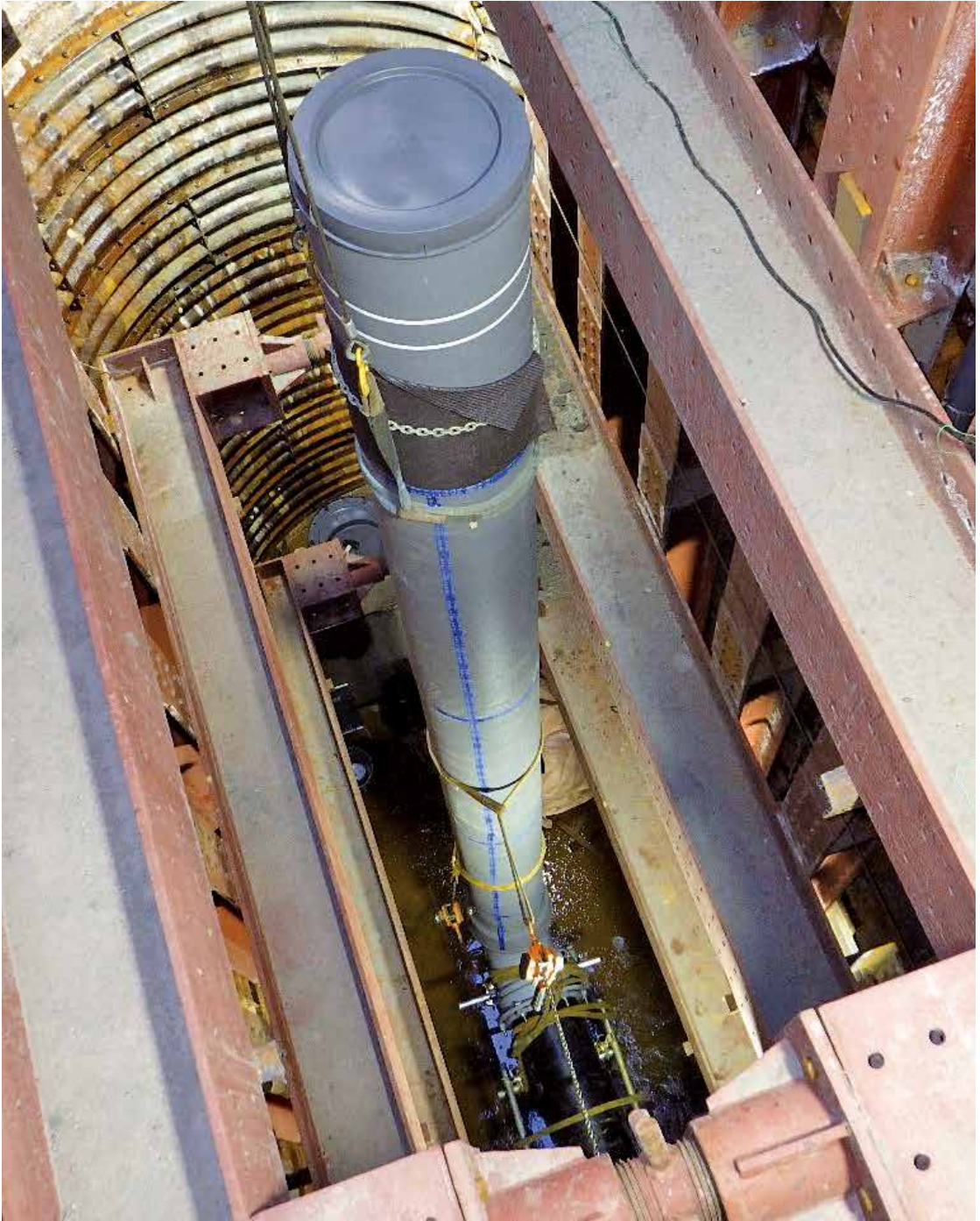
松本市上下水道局（長野県）GX形 呼び径 400
