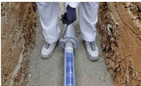
写真5 S50形配管状況④
