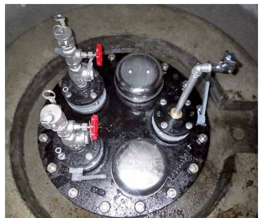
写真8 弁室内給水設備
