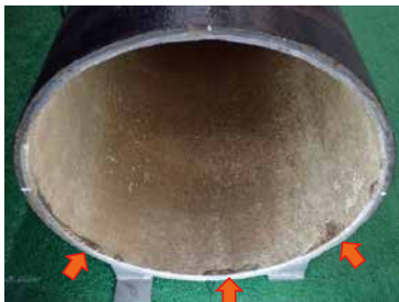
管端部で僅かに剥離した箇所あり
