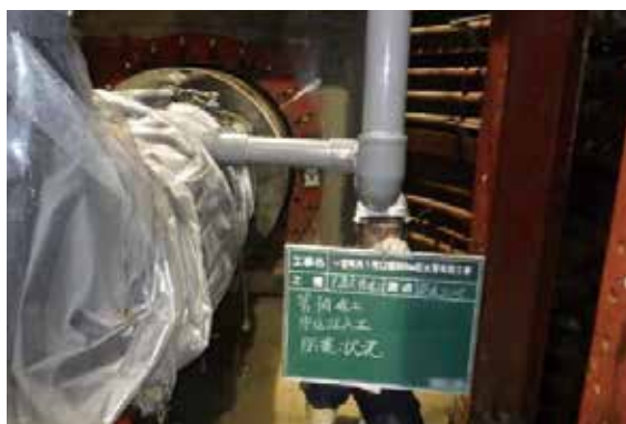
写真 17 中込充填閉塞状況
