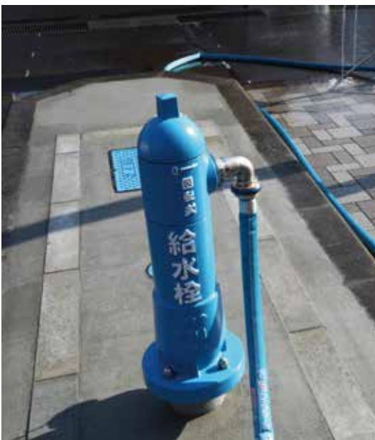
災害時給水栓（提供：仙台市）
