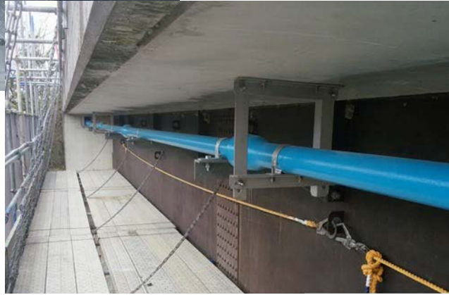
かつらぎ町上下水道課 (和歌山県) NS形E種 呼び径75 (橋梁添架)
