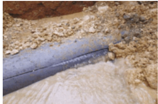
(b) 管体破損の状況
