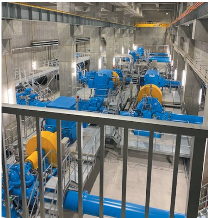
写真5 松原ポンプ場ポンプ設備
