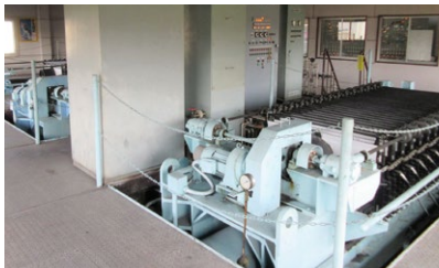
えのくま浄水場脱水機
