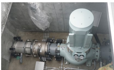
三芳配水場小水力発電設備
