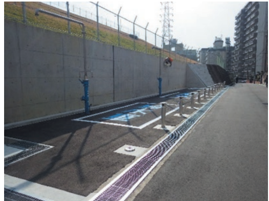
写真1 応急給水栓(寺内配水池)
