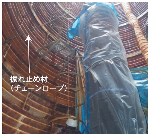
写真7 立坑内NS形配管(振れ止め材)
