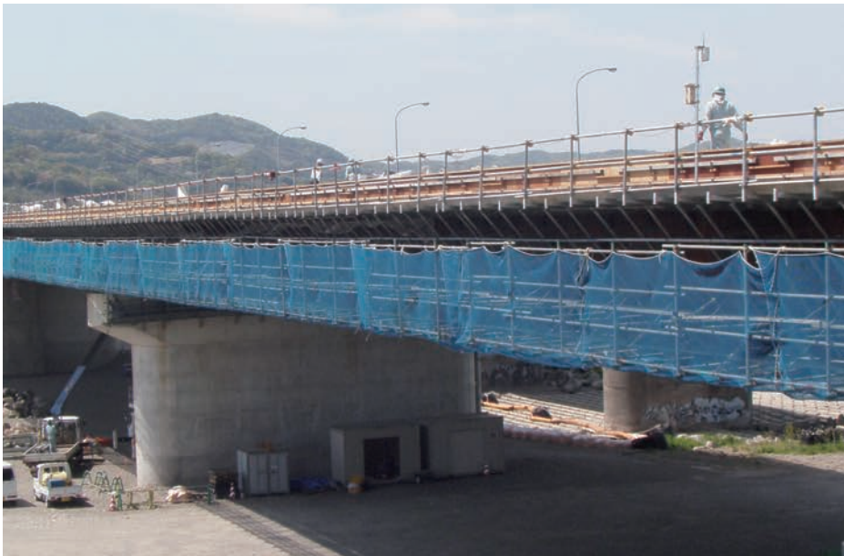
和歌山県 岩出市上下水道局 NS 形 E 種 呼び形 150 橋梁添架 375m
