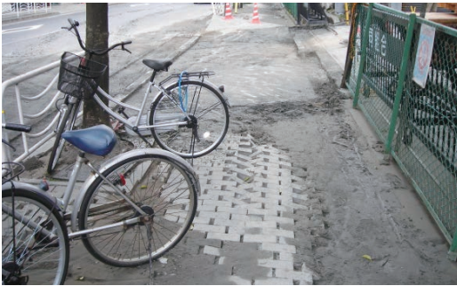
写真6 液状化による噴砂被害(江東区) (東日本大震災)
