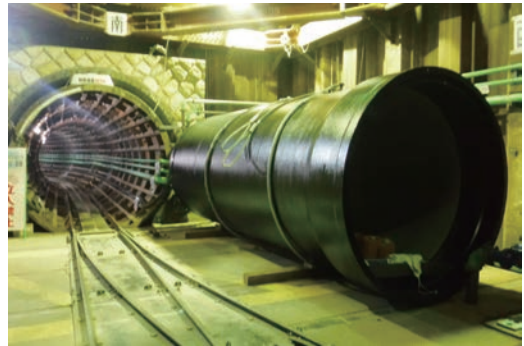
写真2 導水施設の二重化整備状況
