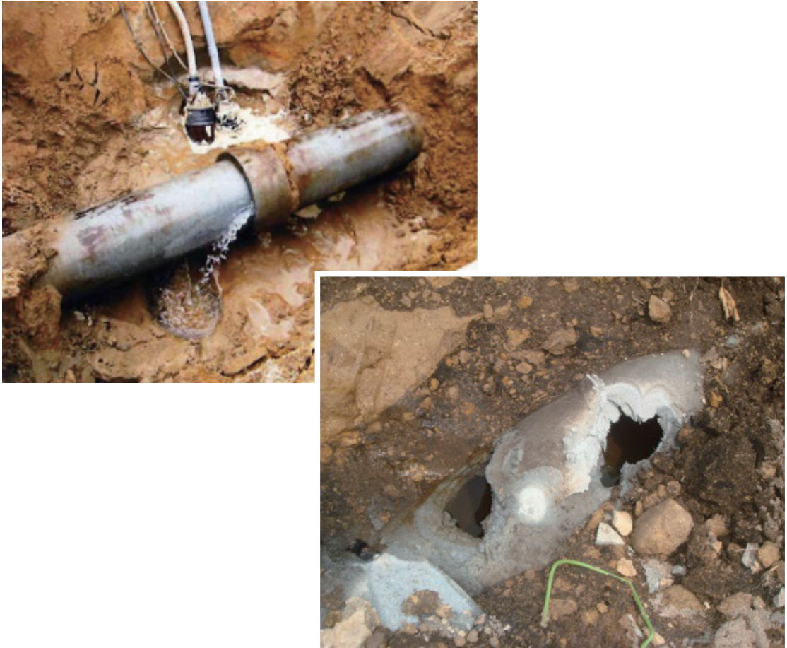
写真1 突発事故の状況
