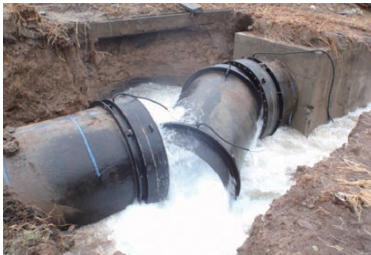
仙南・仙塩広水 伸縮可とう管離脱
