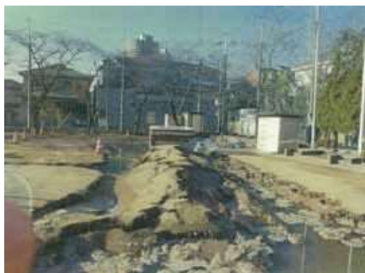
写真1 被災状況(貯水タンク)
