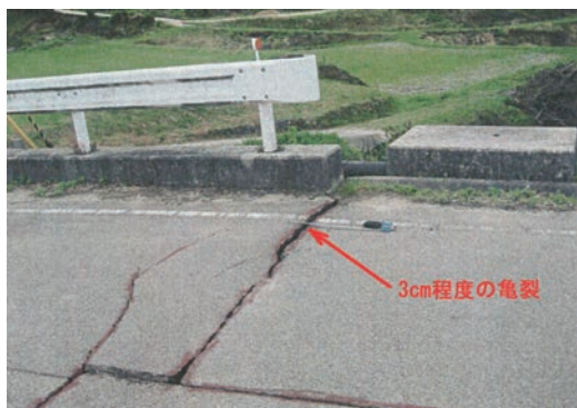
写真1 ため池堤防道路面の亀裂
