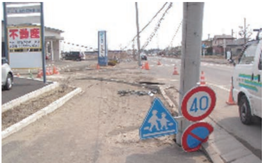
写真1 調査区間の地上の状況 (電柱、標識の沈下)
