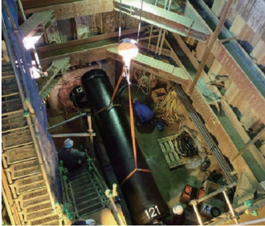
写真5 PN形 管の吊下し状況
