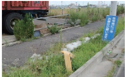
写真2 同左 (歩道の陥没)
