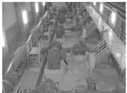
写真1 本城浄水場内送水ポンプ
