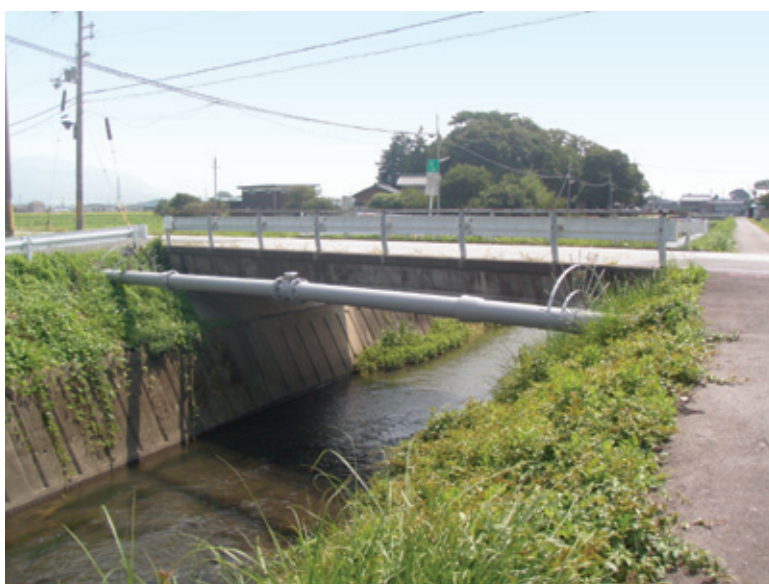
滋賀県 愛知郡広域行政組合水道事務所 FT形 呼び径 300(延長16.26m)
