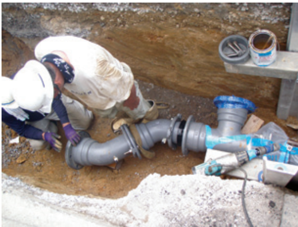
● 大阪府 河南町 まち創造部上下水道課 呼び径 150
