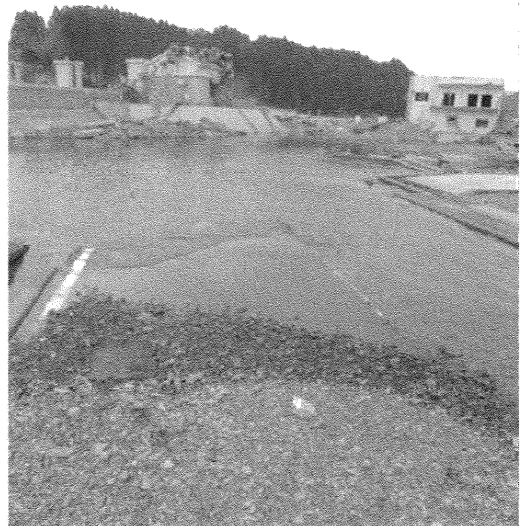
写真5 津波による道路流失
