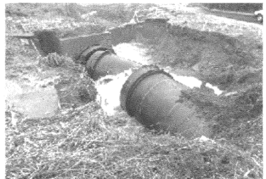
写真9 構造物との取り合い部での呼び径2400鋼製可とう管の抜け 7)
