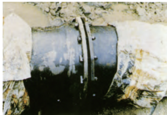
左記の管のスリーブをはがした状態 (管およびボルト・ナットに腐食はなかった)
