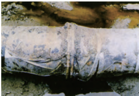
ポリエチレンスリーブ被覆 海底を浚渫した埋立地に埋設されていた 呼び径 600 ダクタイル鉄管 (埋設期間：7 年間)
