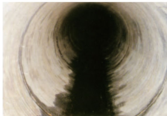
海水を通水した呼び径 1800 モルタルライニング ダクタイル鉄管 (通水期間：4.5 年)
